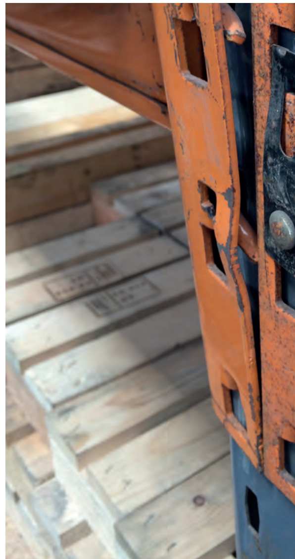
Overbelasting van de palletstelling komt regelmatig voor.
