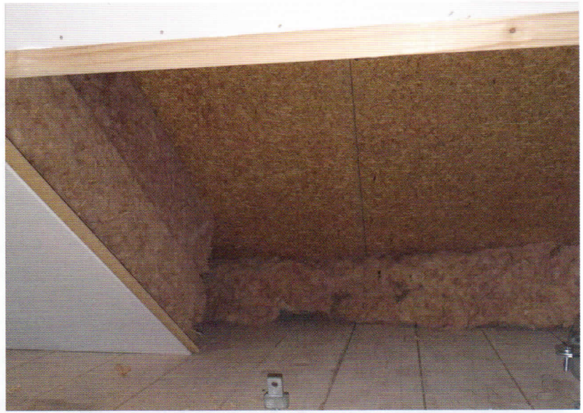
Het dak was aan vervanging toe en is van binnenuit geïsoleerd met het circulaire Isovlas.
