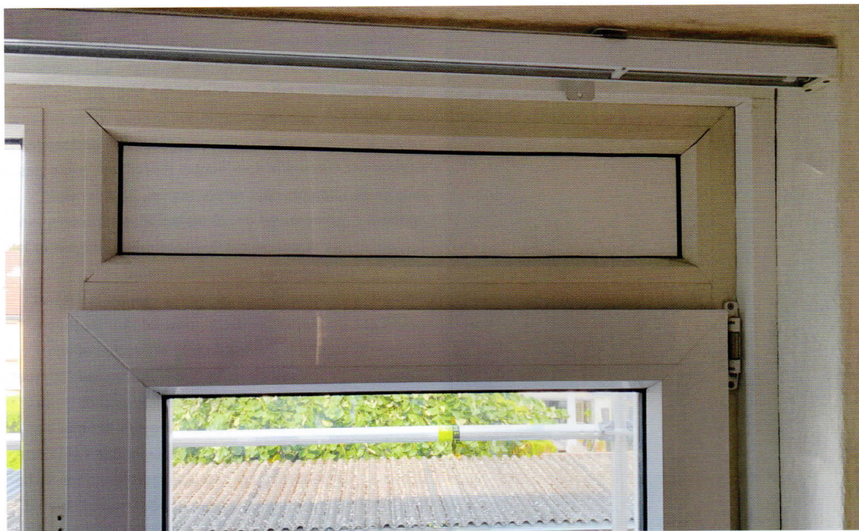
Isolerende panelen op de positie van ventilatieroosters. Ventileren gaat nu vraaggestuurd met wtw.
