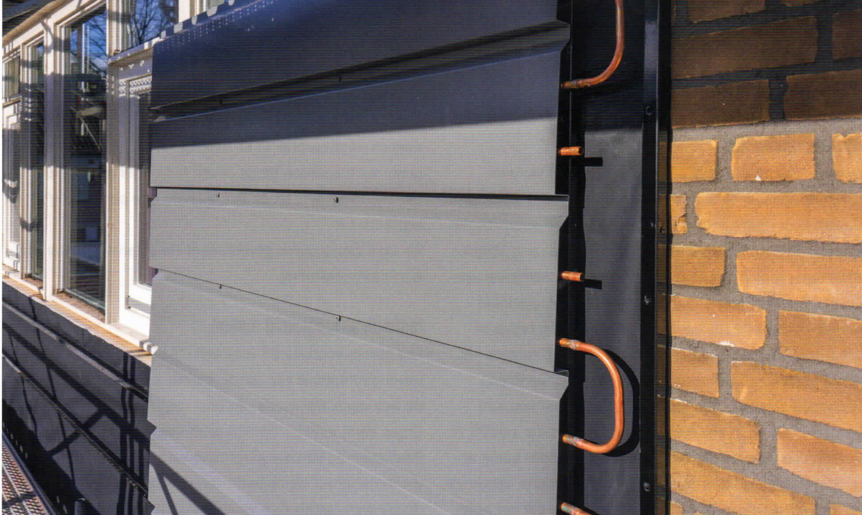
De warmtewingeveld wordt voor de bestaande gevel gemonteerd en zorgt voor warmte en in de toekomst ook voor koeling in de woning. (Foto: Emergo)
