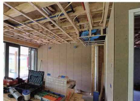
In verlaagde plafonds en koven zijn leidingen weggevoerd.
