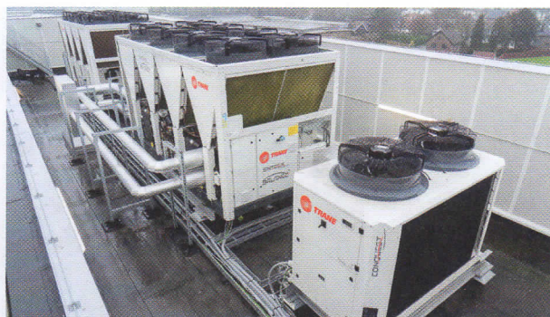
Twee lucht-water warmtepompen van Trane verzorgen ruimtelijke verwarming en koeling in het ziekenhuis.
