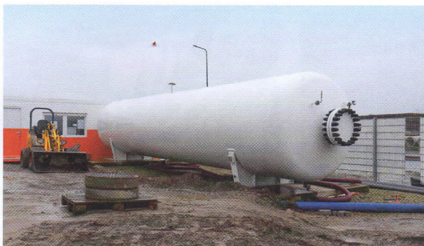
Eén van de twee tanks waarin waterstof wordt opgeslagen op het terrein van Rijnstate Elst.
