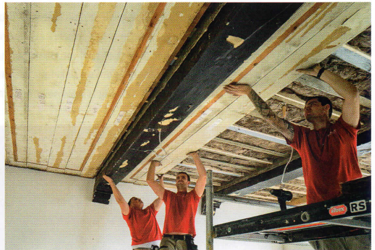
Hier en daar zijn de moerbalken hersteld.
