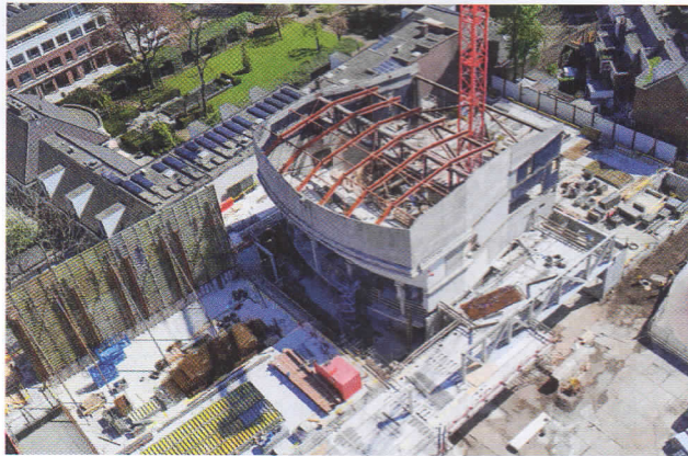
Onder: 3D-doorsnede van de constructie van de toneeltoren en theatertechniek (tekening: Pieters Bouwtechniek).
